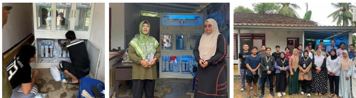
Gambar 1. Gambar Instalasi satu unit Reverse Osmosis untuk BUMdes Batangbatang Daya
